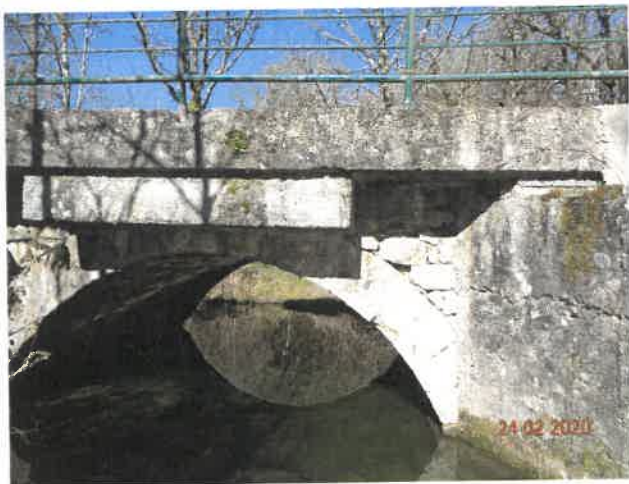
Failles à réparer (Voute) – Potentiellement favorables aux chiroptères
